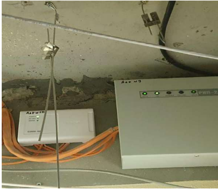
Рис.51. Система ПС не ОКЛ и проложена открыто без пвх защитной гофры.
