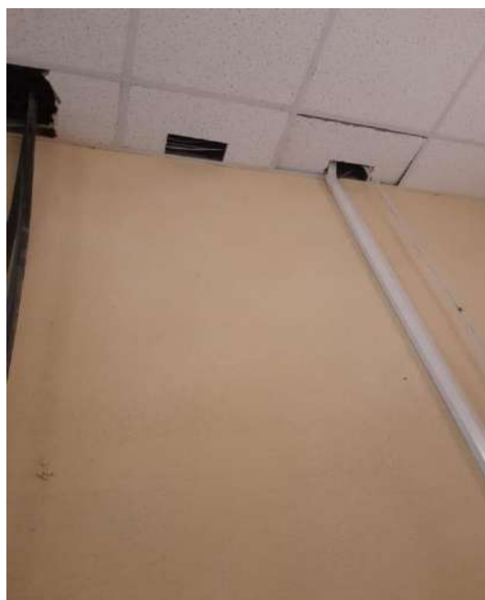
Рис.42 Отсутствие металлических коробов для прокладки линий питания этажных электрощитов.
