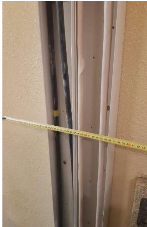
Рис.38. Отсутствуют отдельные линии электроснабжения.
