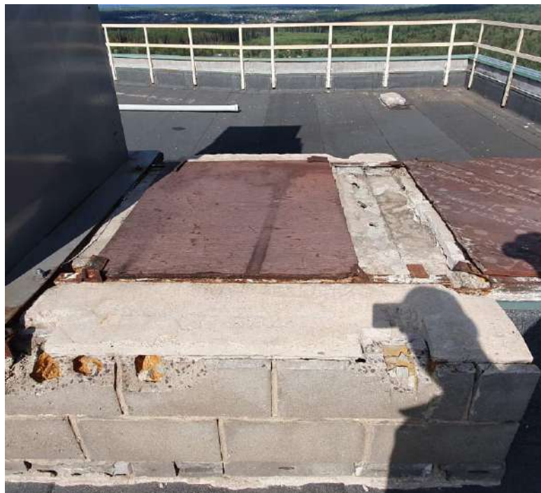
Рис.56 Основания камер дымоудаления не имеет защиты от атмосферных осадков, имеет видимые расслоения и повреждения.
