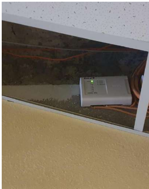
Рис.52. Система ПС не ОКЛ и проложена открыто без пвх защитной гофры.
