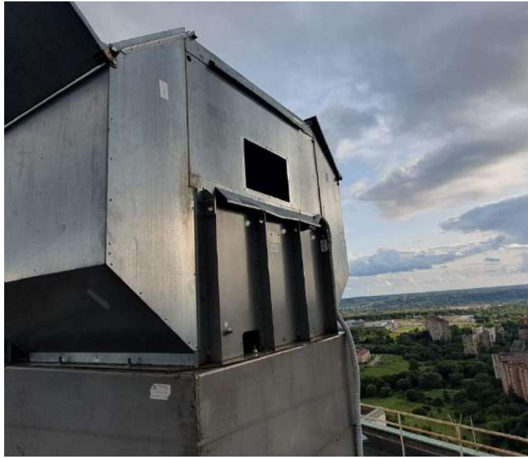
Рис.55. Система питания дымоудаления выполнена ПВХ гофрой для внутренних помещений.
